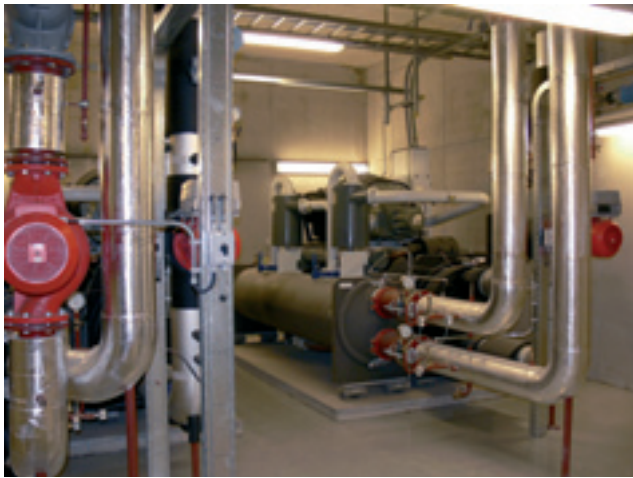
Hightech energiebesparing: van warmteopslag tot HRe-ketel
