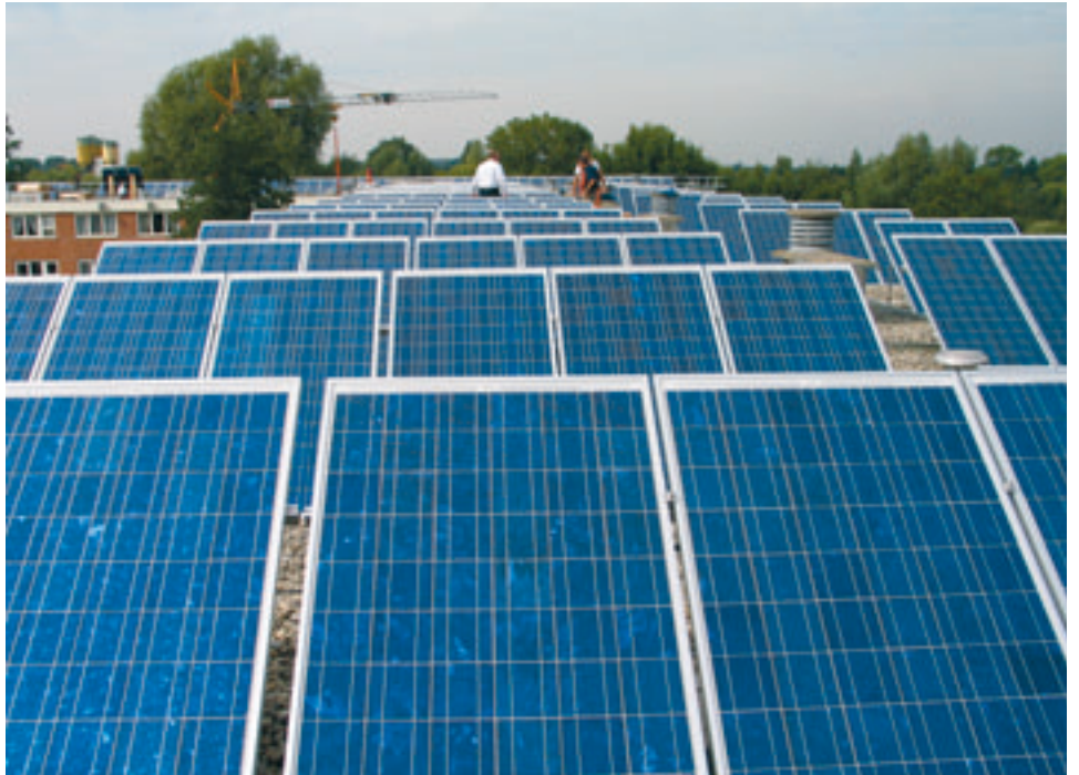
Zonnepanelen op een complex in Amsterdam-Noord. De Dageraad plaatst de panelen uitsluitend op platte daken.
