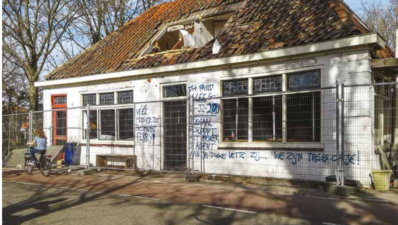
Voormalig café Koffiehuis Kadoelen aan de Landsmeerdijk. Na de ontruiming dit voorjaar begon de eigenaar direct met de sloop van het dorpsmonument. De illegale sloop werd stilgelegd. De eigenaar wil op die plek twee jaren '30 villa's bouwen. Dat plan is eerder afgewezen. De impasse duurt voort.
