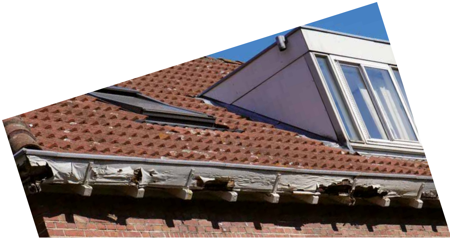
Dakgoot hoek Putterstraat-Sijsjesweg
