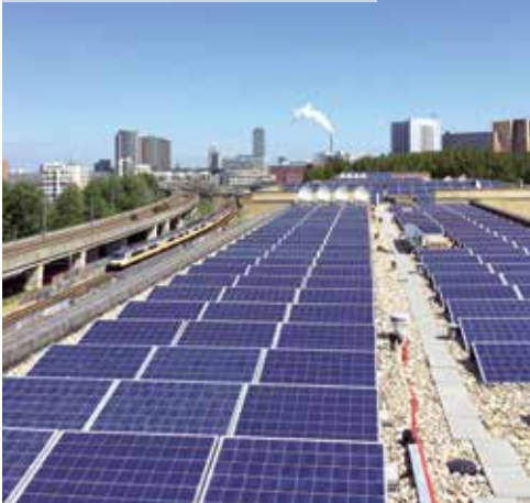
Panelen van HuurDeZon op gebouw de Titaan van Eigen Haard
