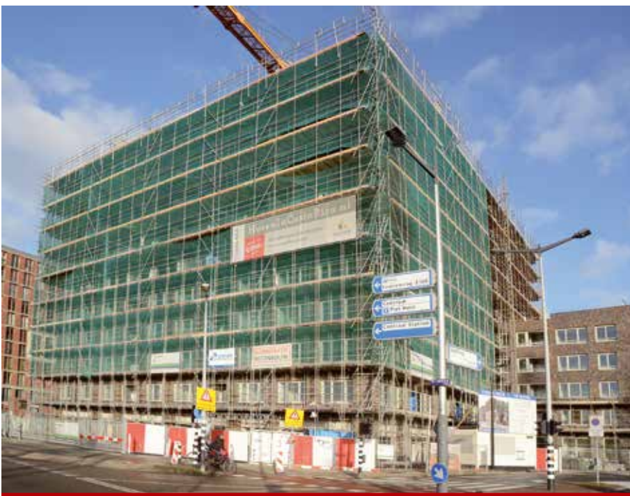
Het woongebouw Costa Rica aan de Oostelijke Handelskade krijgt een mix van sociale huur- en vrijesectorhuur, maar beide groepen krijgen hun eigen entree. In onderste vijf lagen komen 93 sociale huurwoningen van Stadgenoot. In de bovenste vijf verdiepingen verhuurt Altera straks 60 vrije sector huurwoningen. Gemengd wonen, maar wel apart.
