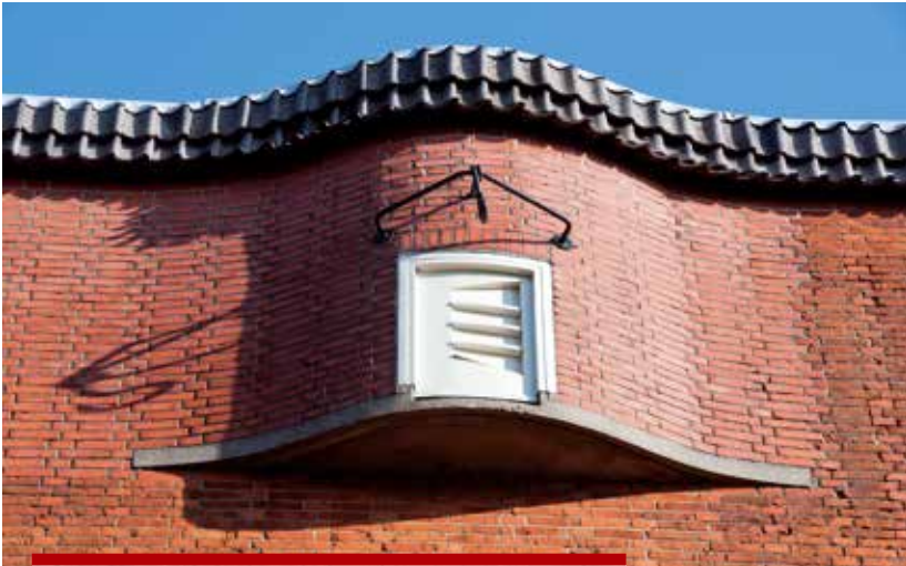
Bij de vorige renovatie zijn licht afwijkende bakstenen gebruikt. Eigen Haard wil dat nu herstellen. De originele stenen zijn indertijd in Groningen gebakken.
