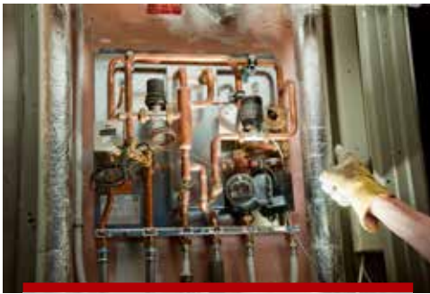
Stadsverwarmingsinstallatie in een Bijlmerflat
